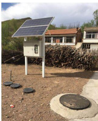
图 4-5 双桥区双峰寺镇下南山村太阳能微动力处理设施
