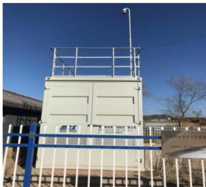
图4-11 围场县哈里哈村一体化污水处理设施
